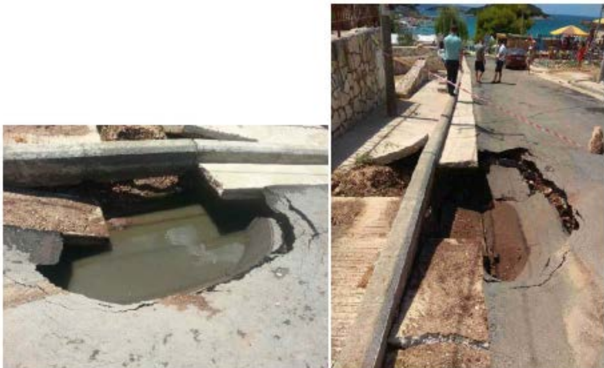
Figure 6–3 Pamje e vendit te shperthimit te tubacionit te dergimit
