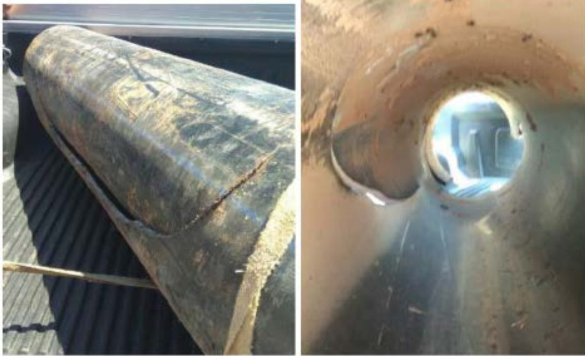
Figure 6–4 Pamje e demtimit te tubacionit gjate shperthimit
